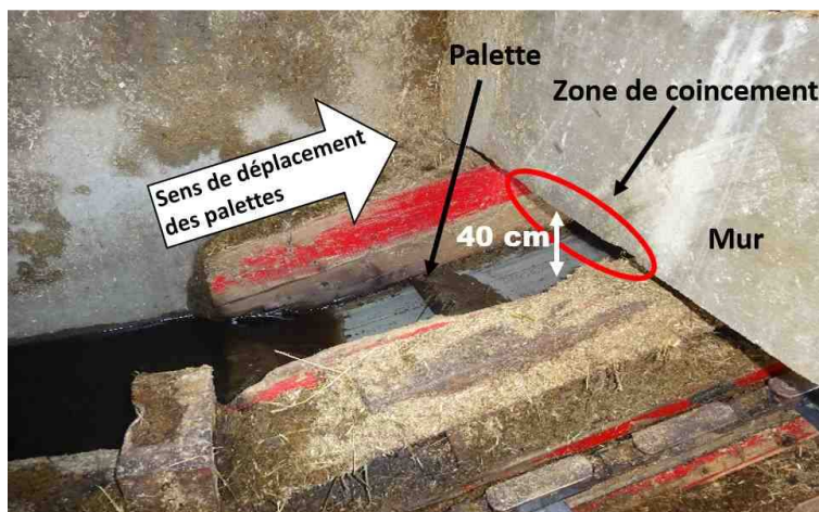
Photo 12 : Zone de coincement (À noter qu'au moment de l'accident, le dalot était rempli de fumier)
