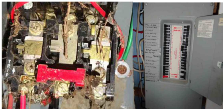
Photo#3 : Protection thermique et panneau de distribution
