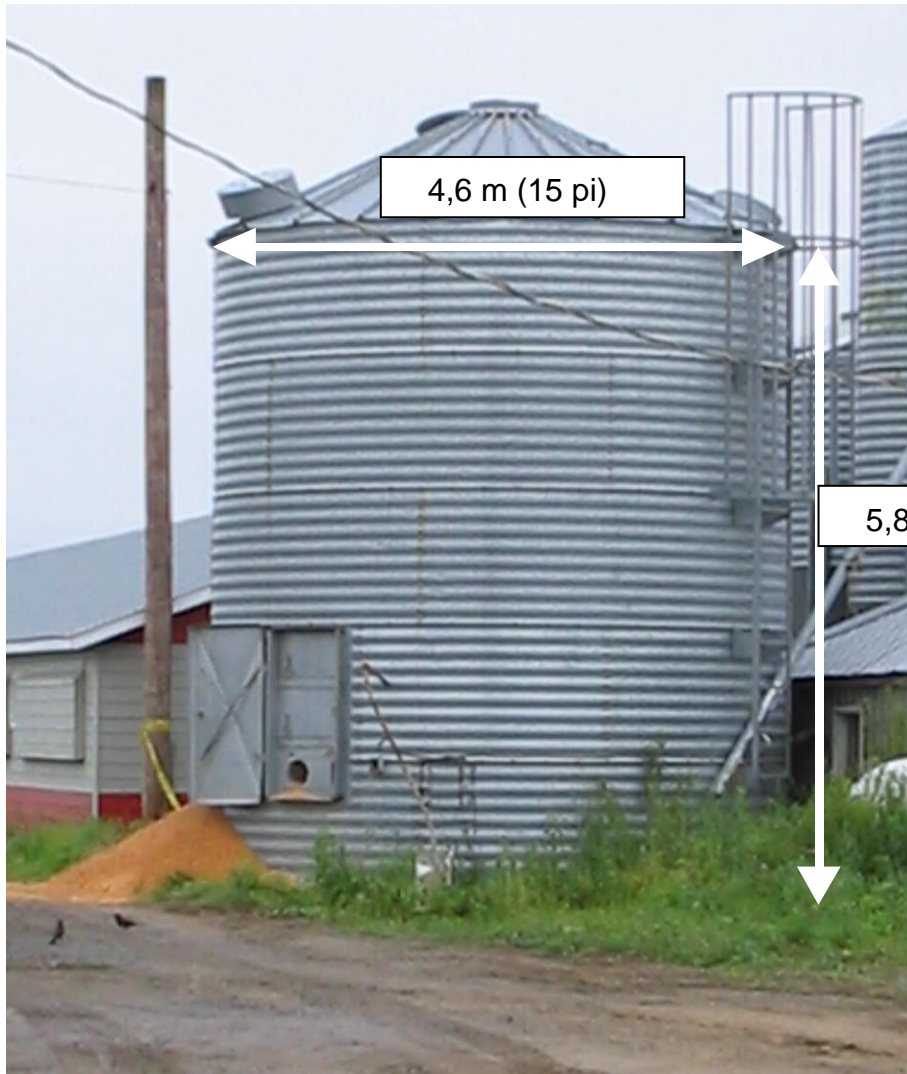
Figure 1 – Silo de grains où est survenu l'accident
