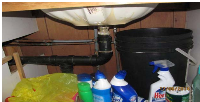
Photo 4 : Vue de la tuyauterie sous l'évier après l'accident (Source: CSST)
