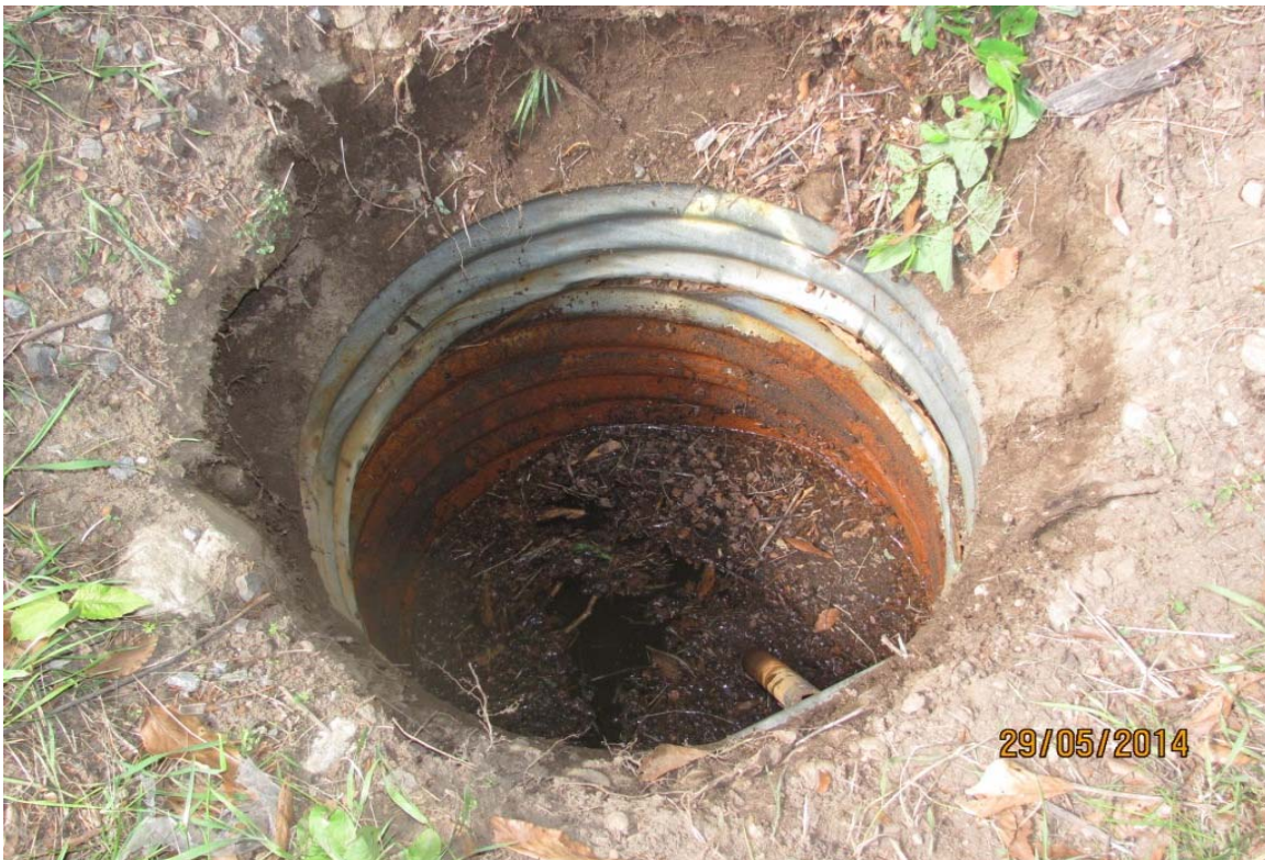
Photo 1 : Trou d'homme donnant accès à la valve d'alimentation en eau potable de la maison mobile (Source: CSST)
