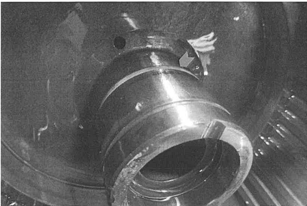
Photo 69 : Vue rapprochée de la photo précédente, montrant que le joint d'étanchéité de l'arbre intérieur de l'embrayage est en bon état.
