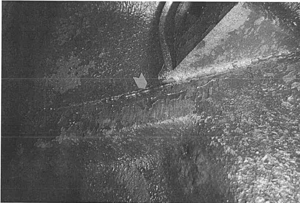
Photo 19 : Vue rapprochée de la photo précédente, montrant la présence d'un joint d'étanchéité non d'origine.
