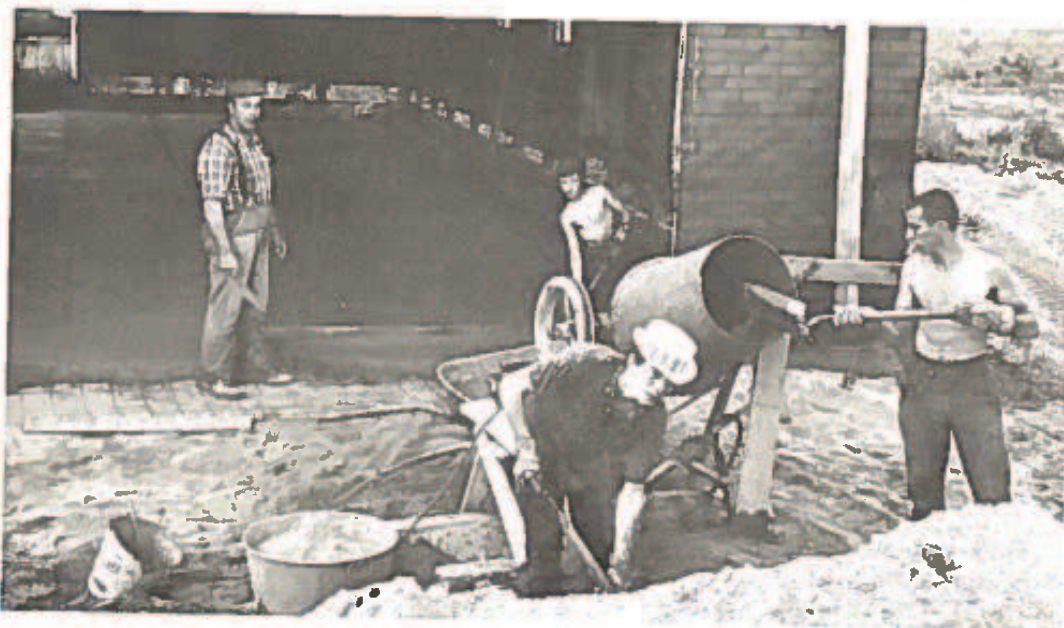
Tous les hommes de la ferme, monsieur Boulet, Bertrand, Jean-Guy et Gilles, s'affairent au coulage du béton pour le plancher de cette construction qui servira à la fois de garage et de remise.
